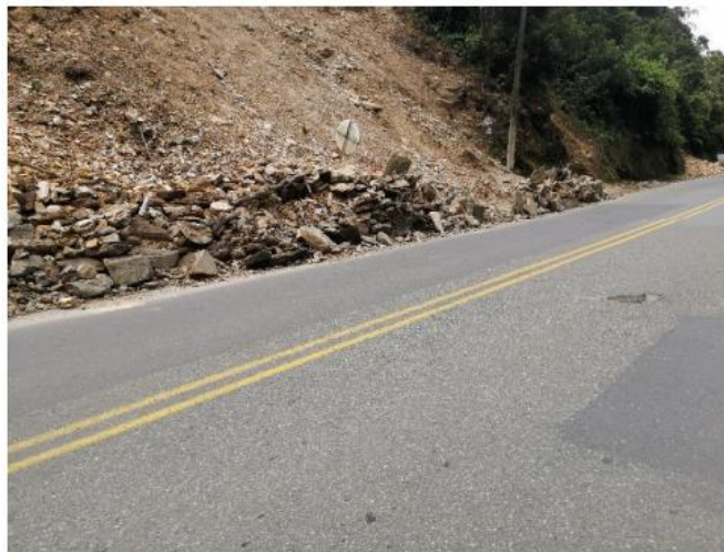
PUNTO 3 gran afectación sobre la vía de material suelto, se observa acumulación de materia por parte de los que realizan la extracción sin ninguna orientación técnica, la señal de tránsito afectada y las cunetas de la vía obstruidas. Coordenadas al sistema MAGNA-SIRGAS Lat: 7.06989°N Lon: 75.45294°W
