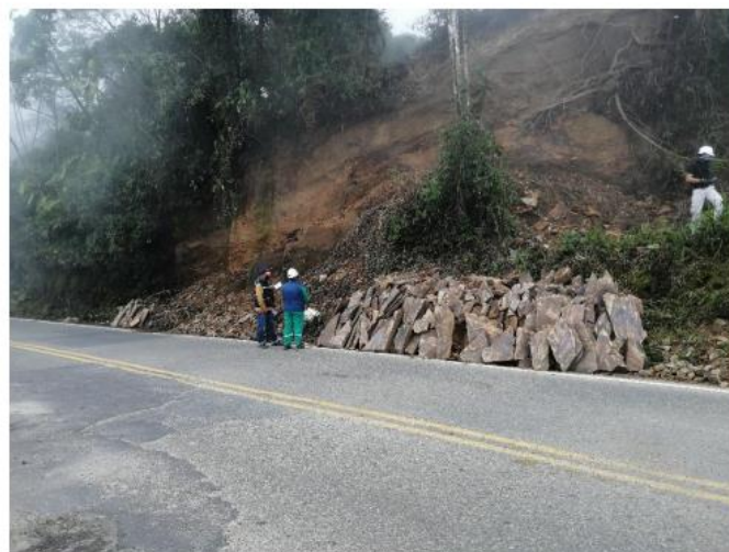
PUNTO 4 material extraído y seleccionado para la venta en la orilla de la vía obstruyendo las cunetas de la vía Coordenadas al sistema MAGNA-SIRGAS Lat: 7.08691°N Lon: 75.46983°W
