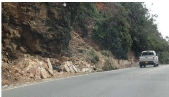
Situación en octubre de 2019 sector de socavación minera, sector ventanas.
