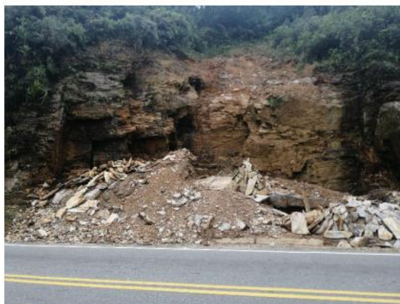
PUNTO 1 material extraído sobre la vía con taludes en contra pendiente de 2 a 4 metros de altura, se observan obstrucción a las cunetas viales Coordenadas al sistema MAGNA-SIRGAS Lat: 7.06441°N Lon: 75.44791°W
