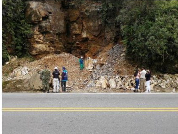
PUNTO 2 se observan bloques de material separado para la venta y taludes de 2 a 6 metros de altura en contrapendiente, también se observa obstrucción a las cunetas de las vía. Coordenadas al sistema MAGNA-SIRGAS Lat: 7.06709°N Lon: 75.44762°W
