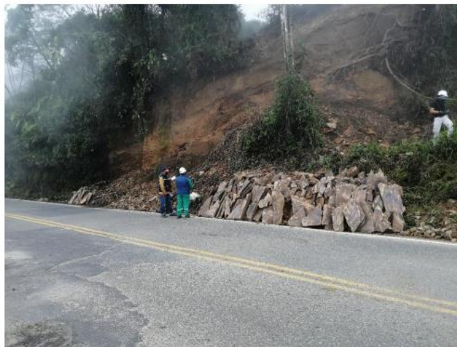
PUNTO 4 material extraído y seleccionado para la venta en la orilla de la vía obstruyendo las cunetas de la vía Coordenadas al sistema MAGNA-SIRGAS Lat: 7.08691°N Lon: 75.46983°W
