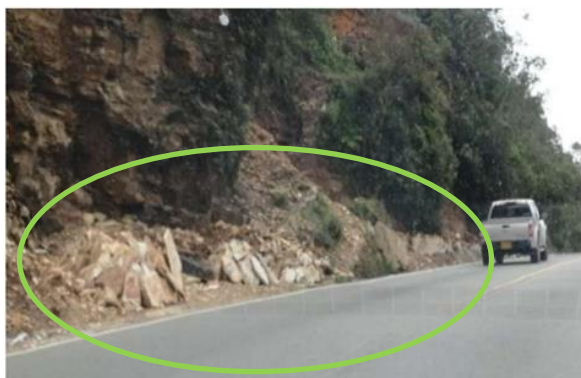
Situación en octubre de 2019 sector de socavación minera, sector ventanas.
