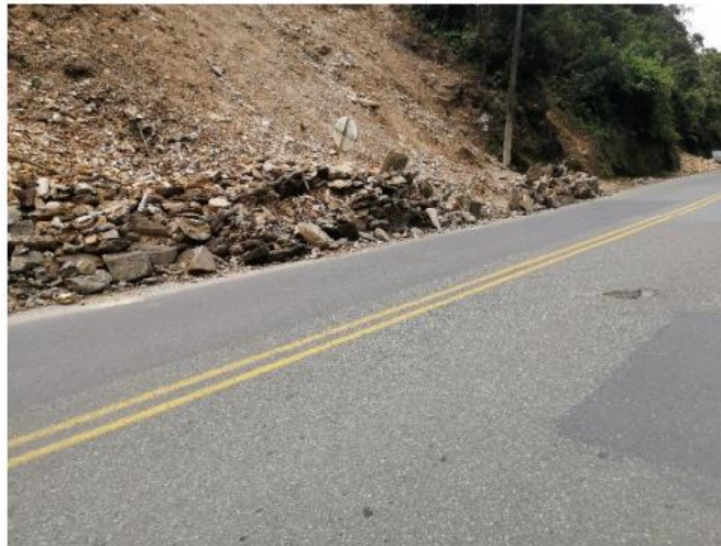
PUNTO 3 gran afectación sobre la vía de material suelto, se observa acumulación de materia por parte de los que realizan la extracción sin ninguna orientación técnica, la señal de tránsito afectada y las cunetas de la vía obstruidas. Coordenadas al sistema MAGNA-SIRGAS Lat: 7.06989°N Lon: 75.45294°W
